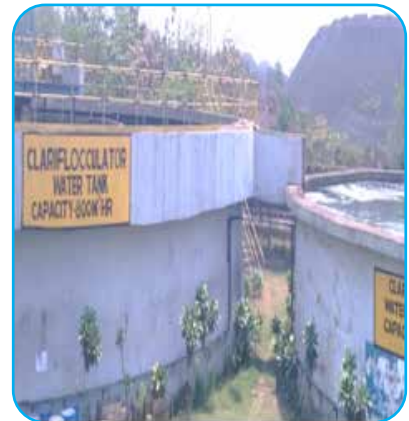
STP, ERS & WATER TREATMENT
